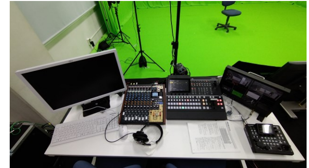
プレゼン資料投影用パソコン 映像スイッチャー 音声スイッチャー 撮影確認用モニター PTZカメラコントロールユニット
